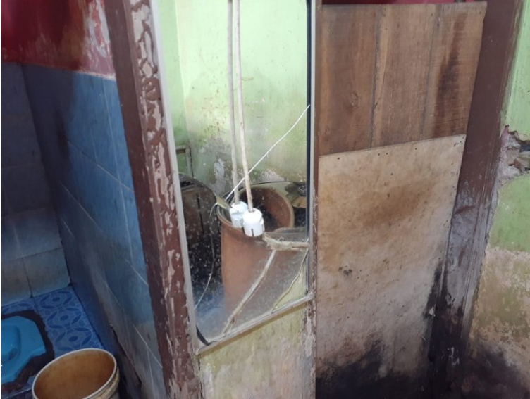
Gambar 6. Kondisi Toilet yang Tidak Memadai
