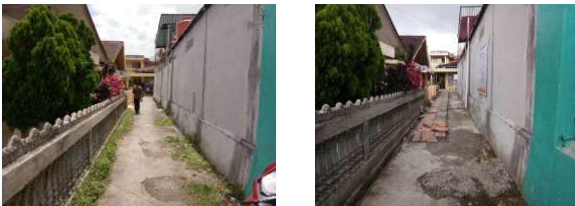
Gambar 4.1 Kondisi Jalan Paving sebelum (Kiri) dan Kondisi 25 % (Kanan) Program Kotaku di Kelurahan Pakan Kurai
