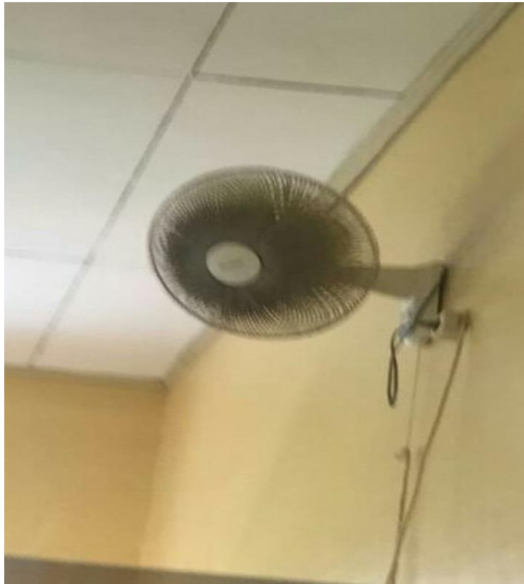
Foto 6,1. Kondisi Kipas Angin di Ruang IKA Instalasi Rawat Inap RSUD Pariaman
